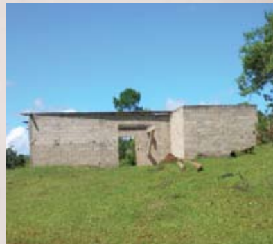
Igreja: Construção interrompida
